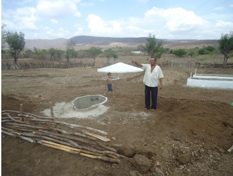
Figura 1 – Vista geral da cisterna com os decantadores em primeiro plano
